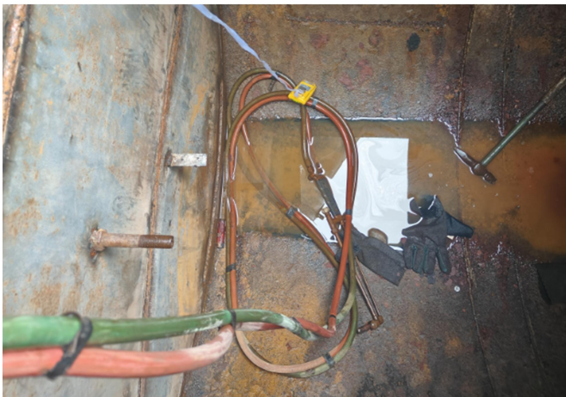
图 5 事故位置及管道内部
