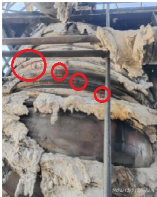
图6 蒸馏釜外壁导热油盘管裂缝、保温棉脱落
