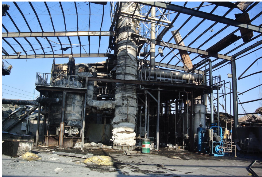
图 3 事故现场全貌
