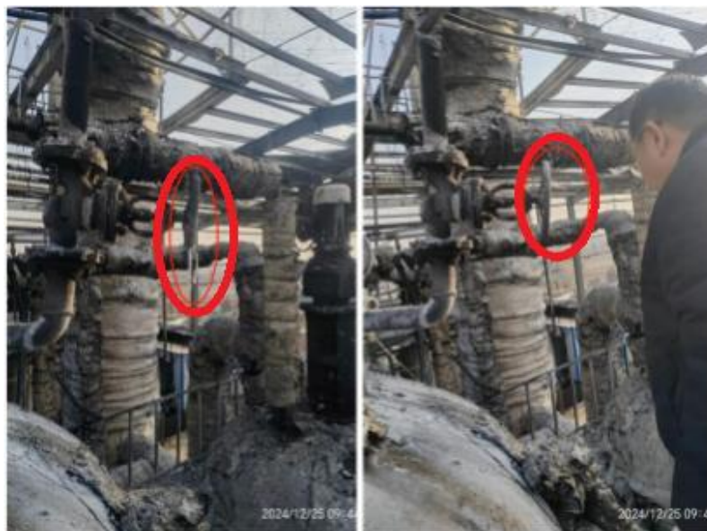
图8 现场勘察蒸馏釜1放空阀操作前后相差半圈
