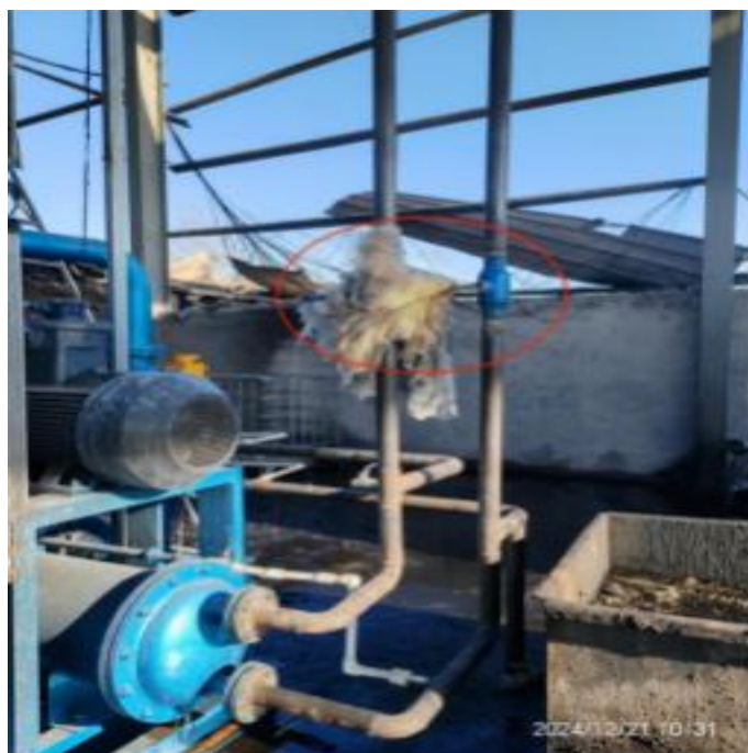
图7 真空泵循环冷却水阀门关闭
