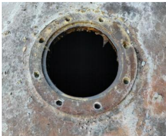
图5 蒸馏釜视镜、压盖法兰、连接螺栓被炸飞
