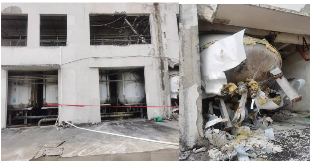
事故现场全景图
