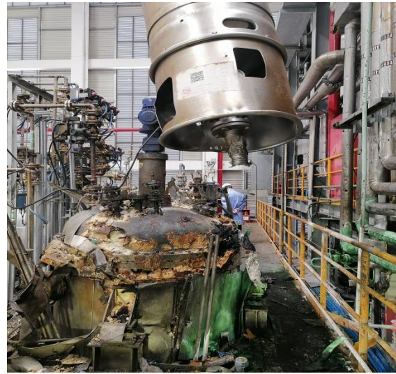
图 6 损毁的 R3801 配制釜
