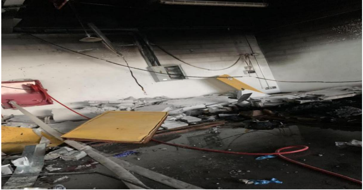
(图 4, 5 楼北部破坏现场照片)
