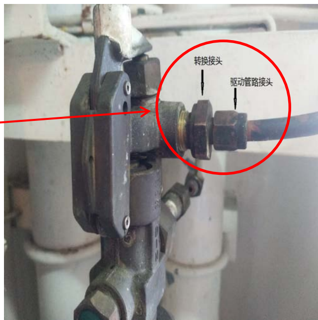
图 4 增压阀连接气动管路局部
