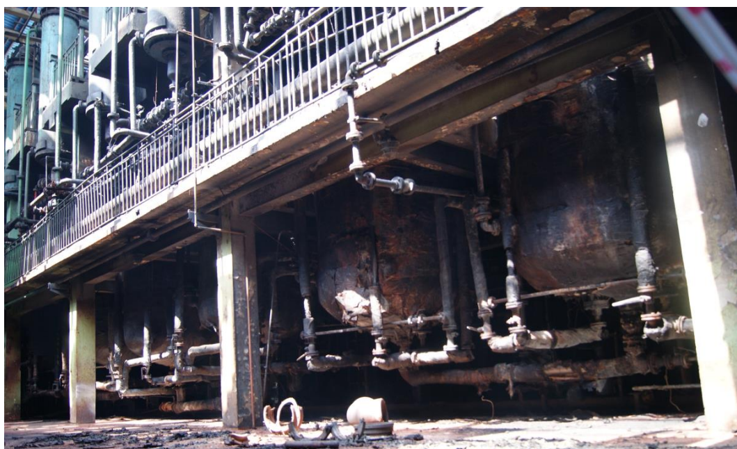
图1 事故水解釜底端
