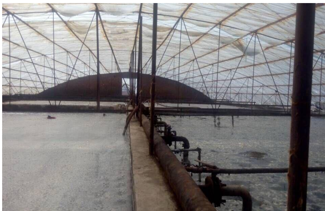
图 1 发生事故的好氧池内部
