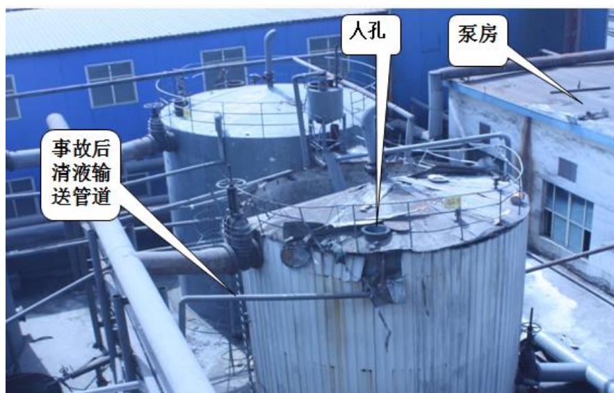
图 1 事故后循环槽顶部
