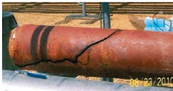
图1：直径约300mm的低温管线破裂
