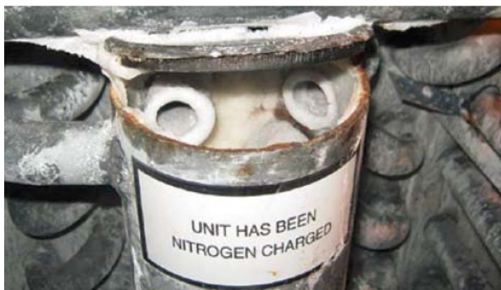
图2：蒸发器盘管焊接位置失效
