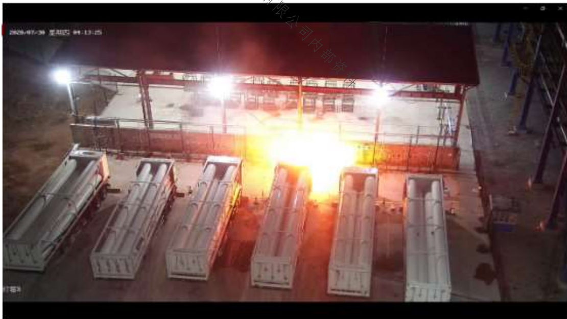
图 4 4 号车操作箱前方软管氢气泄漏处起火燃烧
